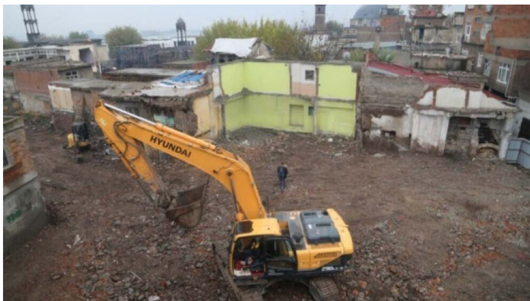
Soumis à un siège de cinq mois en 2015-2016, le district de Sur, dans le centre historique de Diyarbakir, a été vidé de sa population et presque entièrement rasé par l'armée turque
